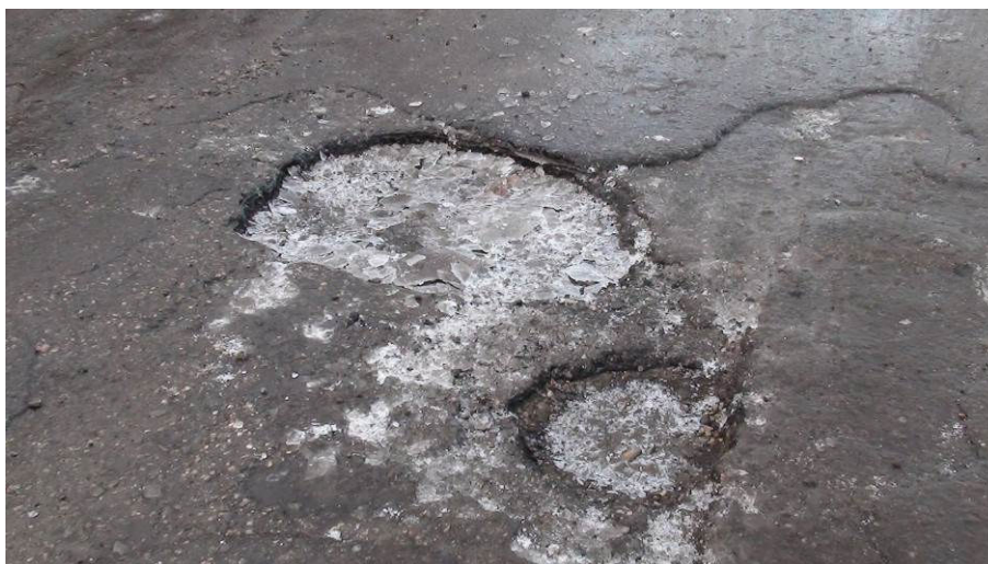
Bedres esošajā asfaltbetona segumā.
